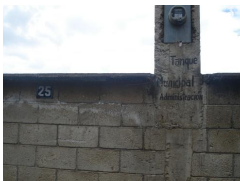
Ubicación del Proyecto. Acometida Eléctrica / contador
